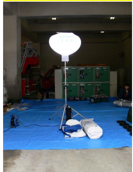
夜間照明を装備
