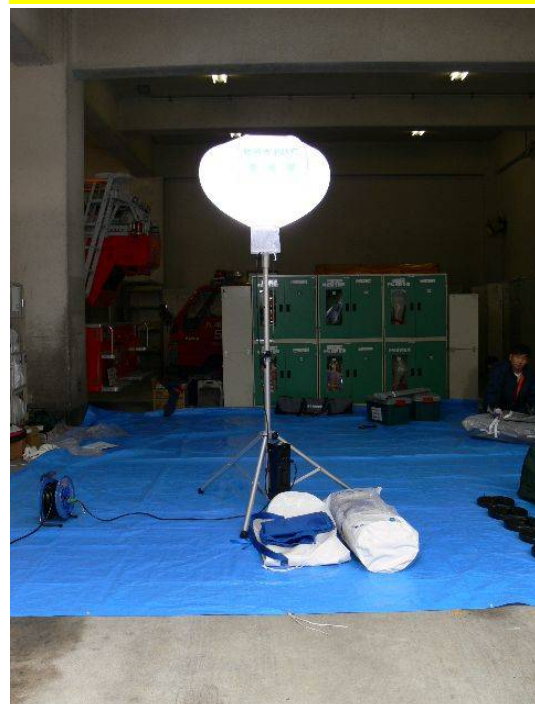
夜間照明を装備
